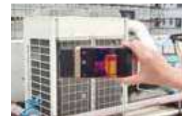
Проверка систем вентиляции
